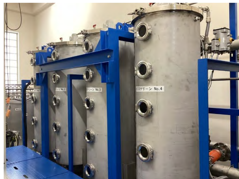
対象地に設置した水処理施設
