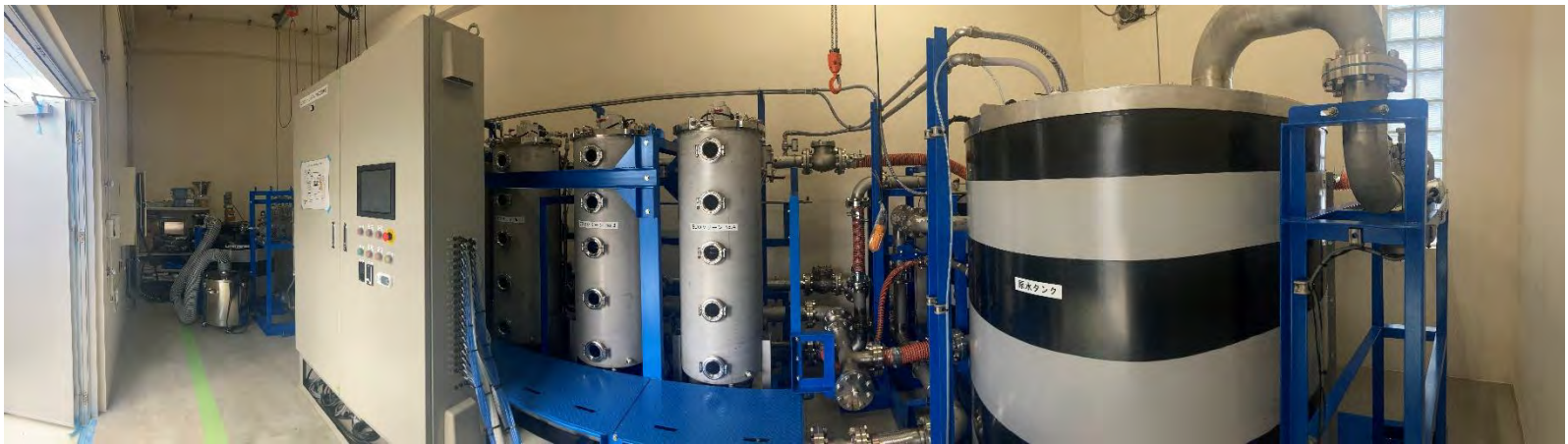
浄化装置 全景
