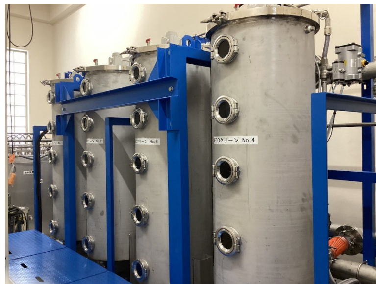
対象地に設置した水処理施設
