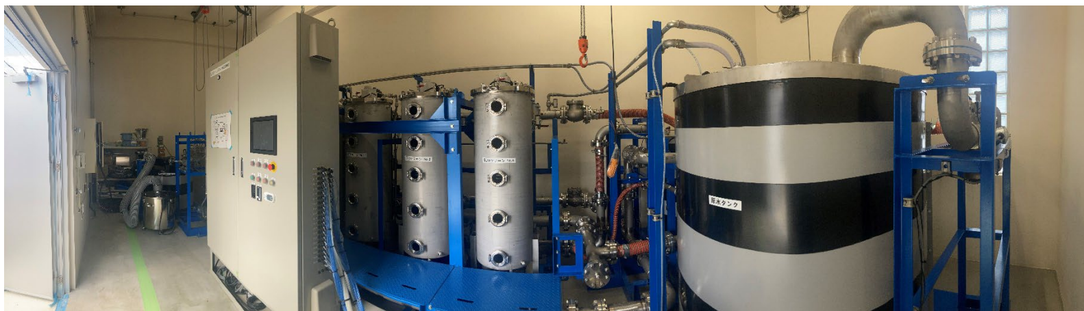
浄化装置 全景
